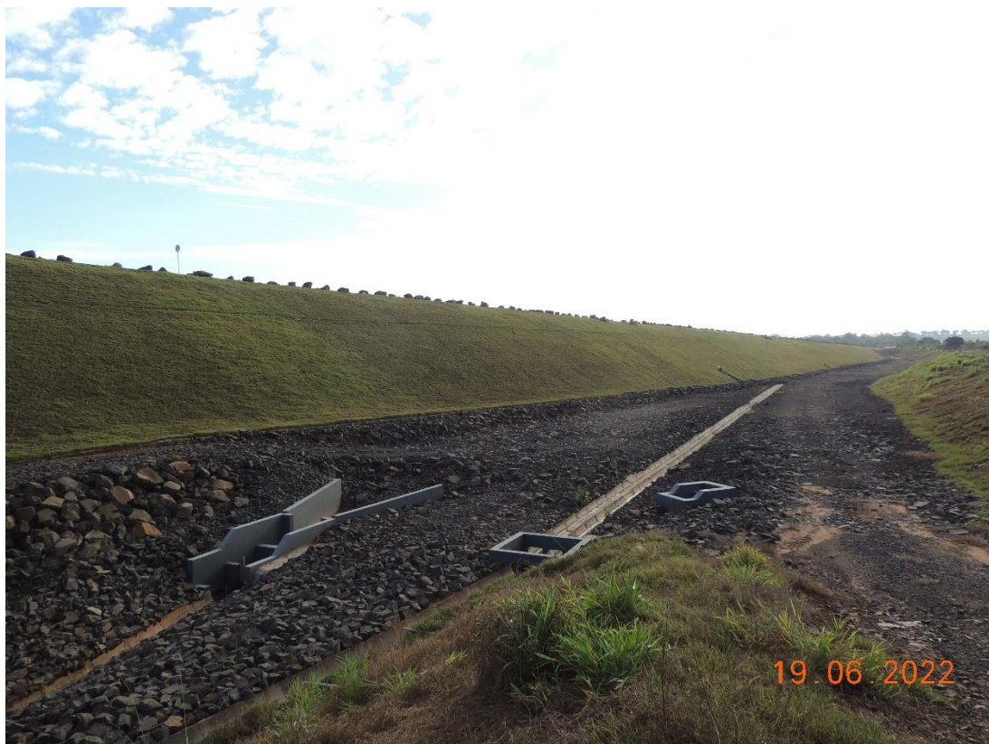
Figura 24 - Área de acesso provisório à jusante encontra-se completamente revestida por grama em leiva plantada.
