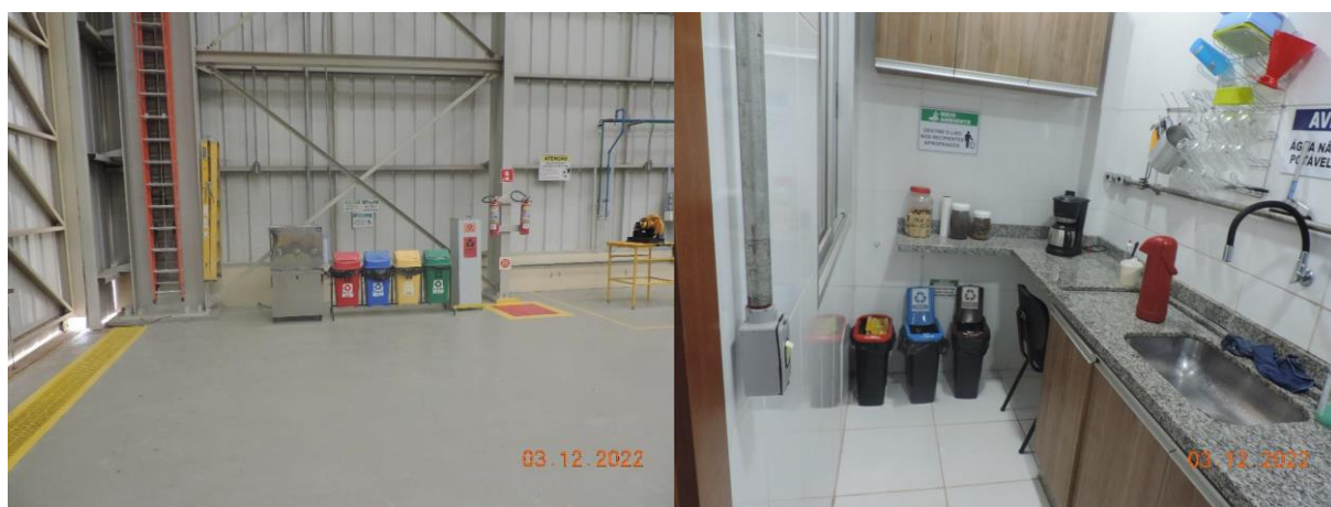
Figura 1. Recipientes para coleta seletiva na área interna da casa de força. Foto: Cedro
