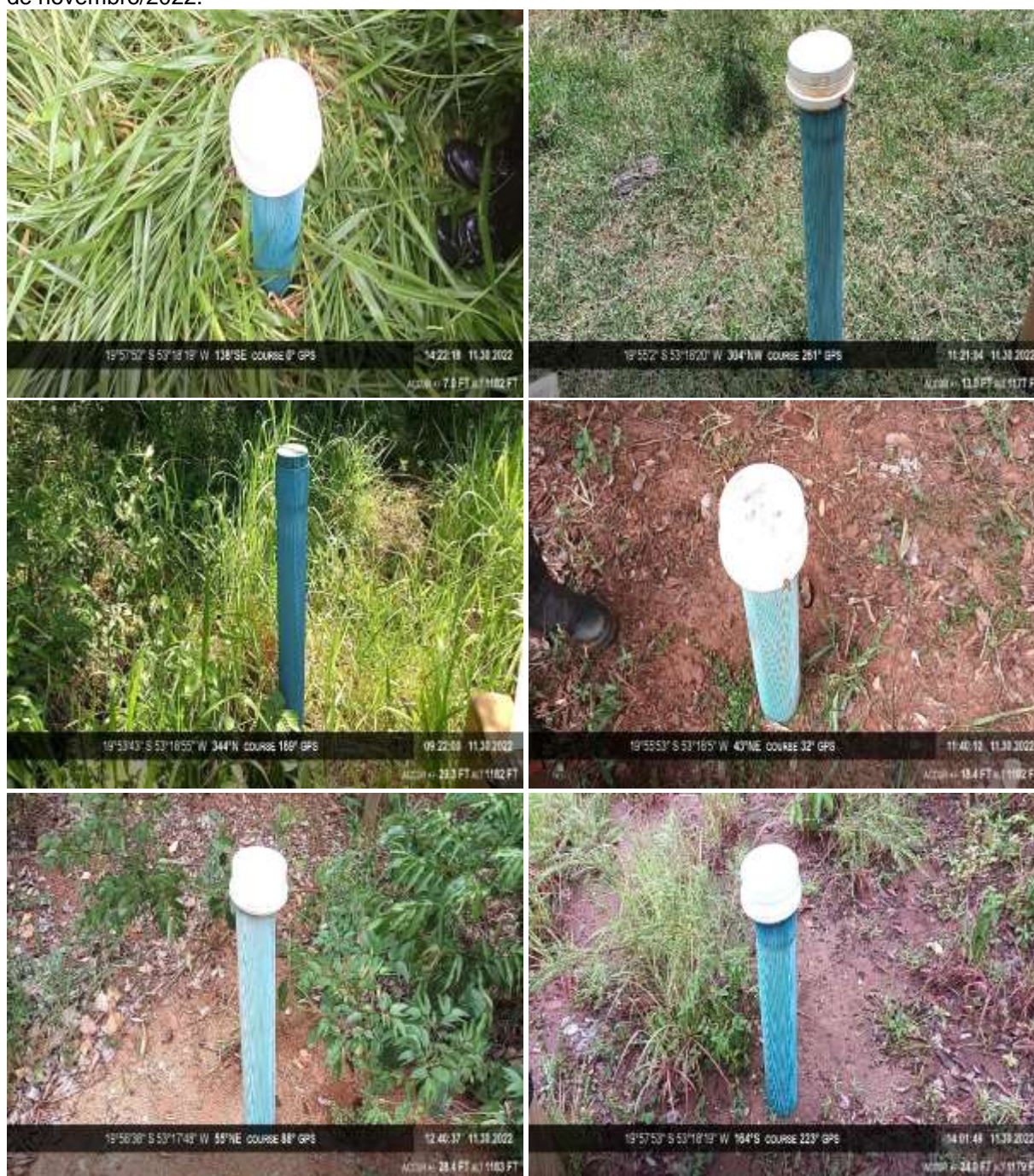
Figura 2 - Poços de monitoramento da PCH Verde 4. Pontos de cima para baixo: P1 a P6. Campanha de novembro/2022.
