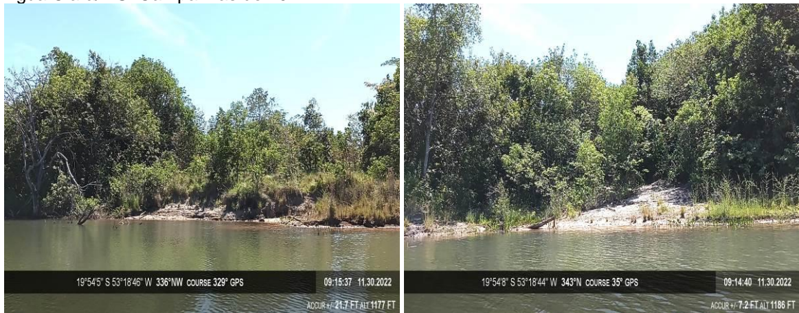
Figura 13. Ponto 11: Erosão laminar na margem esquerda da área 1 da PCH Verde 4, no município de Água Clara/MS. Campanhas de 2022.
