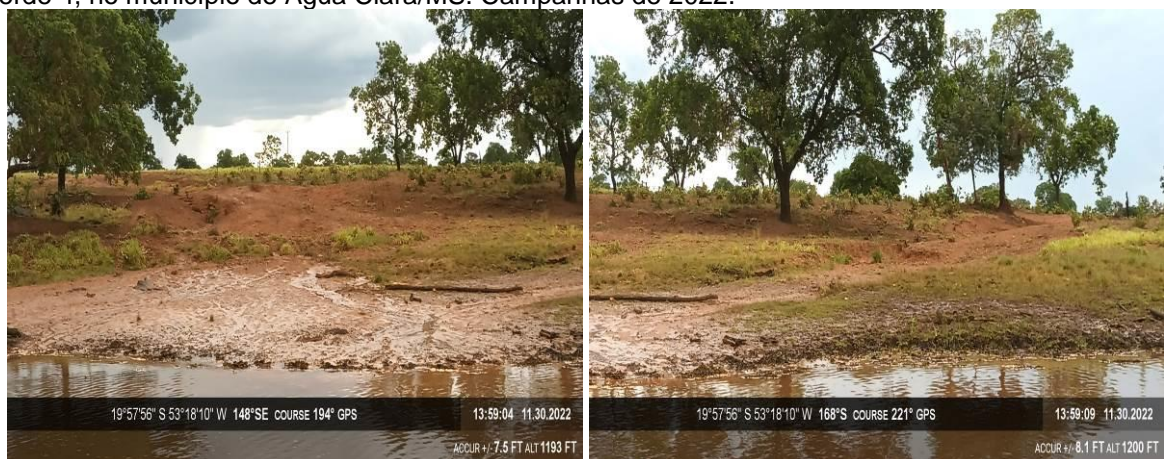
Figura 8. Ponto 5: Erosão em sulcos no afluente da margem direita do reservatório na área 1 da PCH Verde 4, no município de Água Clara/MS. Campanhas de 2022.
