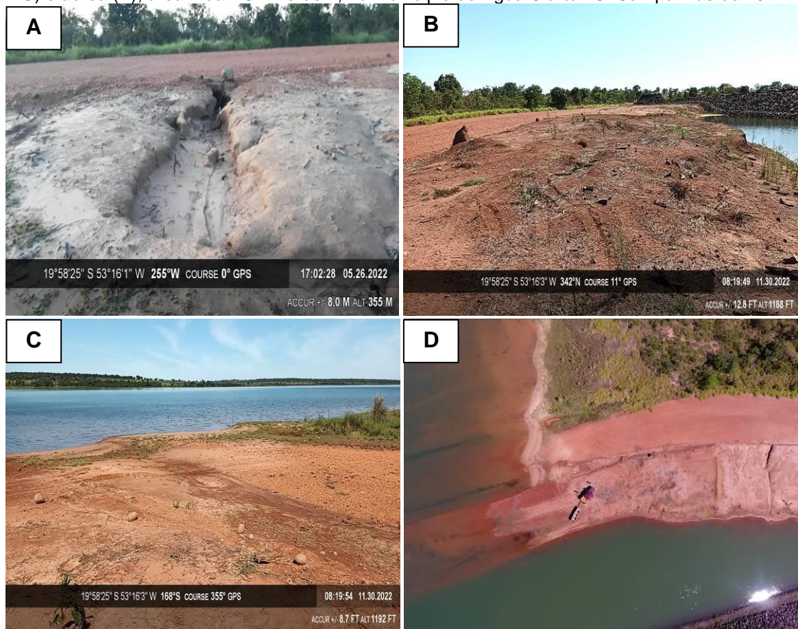
Figura 4. Ponto 1: Erosão em ravinas na margem, ausência de cascalho ou vegetação, vista terrestre (A - C) e aérea (B), área 1 da PCH Verde 4, no município de Água Clara/MS. Campanhas de 2022.
