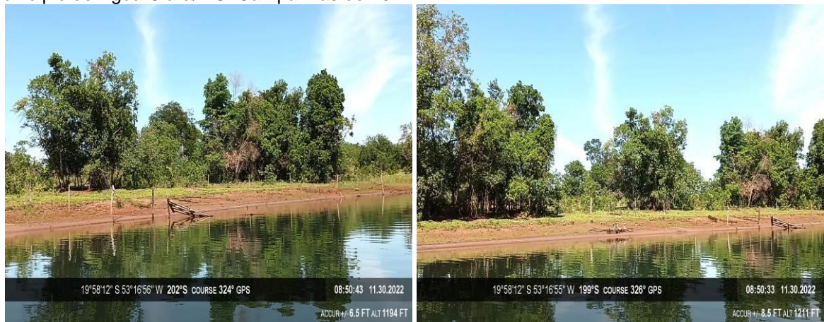
Figura 6. Ponto 3: Erosão laminar na margem direita do reservatório na área 1 da PCH Verde 4, no município de Água Clara/MS. Campanhas de 2022.
