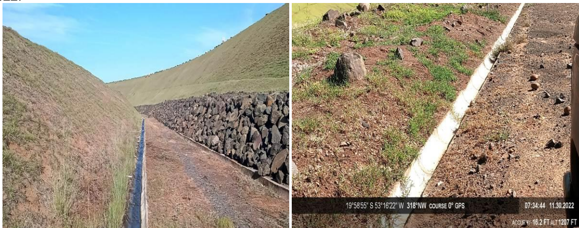
Figura 18. Caneletas de escoamento da PCH Verde 4; Município de Água Clara/MS. Campanhas de 2022.
