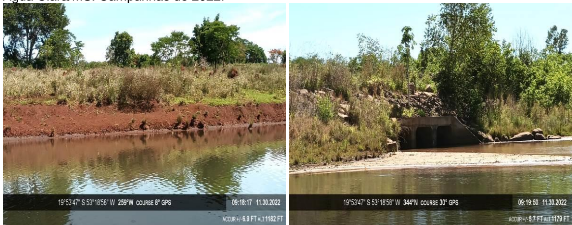
Figura 14. Ponto 12: Erosão laminar na margem esquerda da área 1 da PCH Verde 4, no município de Água Clara/MS. Campanhas de 2022.
